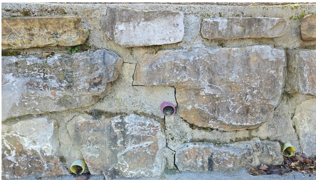
Slika 13: Napetostne razpoke v kamnitem zidu ob asfaltni ploščadi na severnem robu območja 1.
