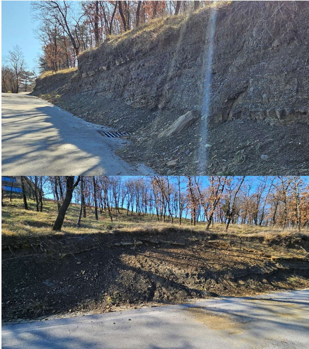
Slika 7: Neugoden vpad plasti (zgoraj) in zdrs plasti fliša zaradi neugodnega naklona plasti glede na naklon pobočj (spodaj).
