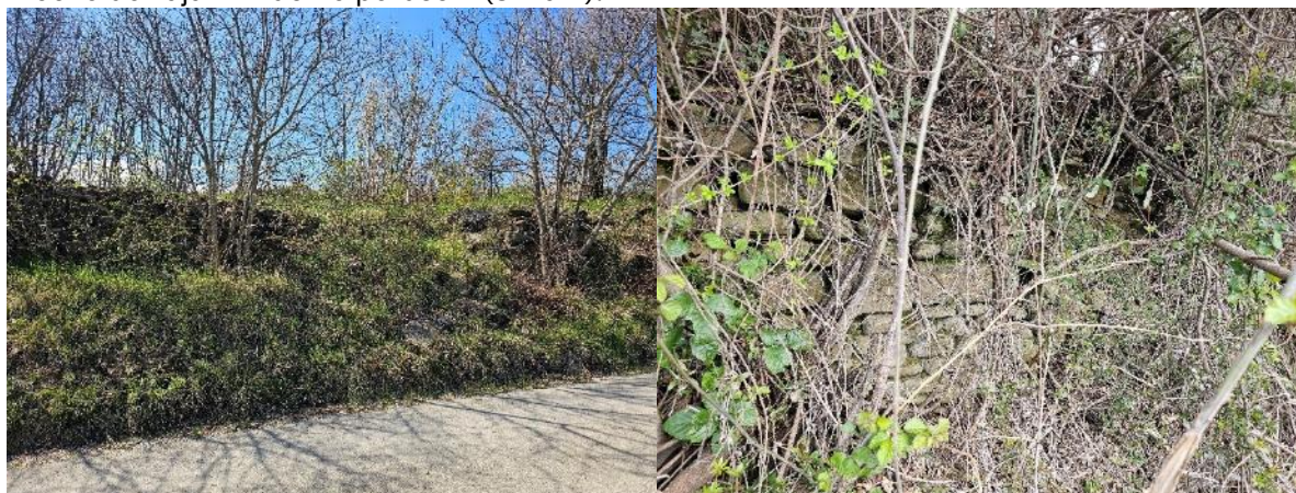
Slika 9: Primeri dotrajanih in delno porušenih suhih zidov
